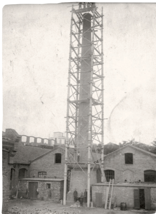
Construcció d'una xemeneia d'obra amb bastida exterior, a principis del segle xx.
